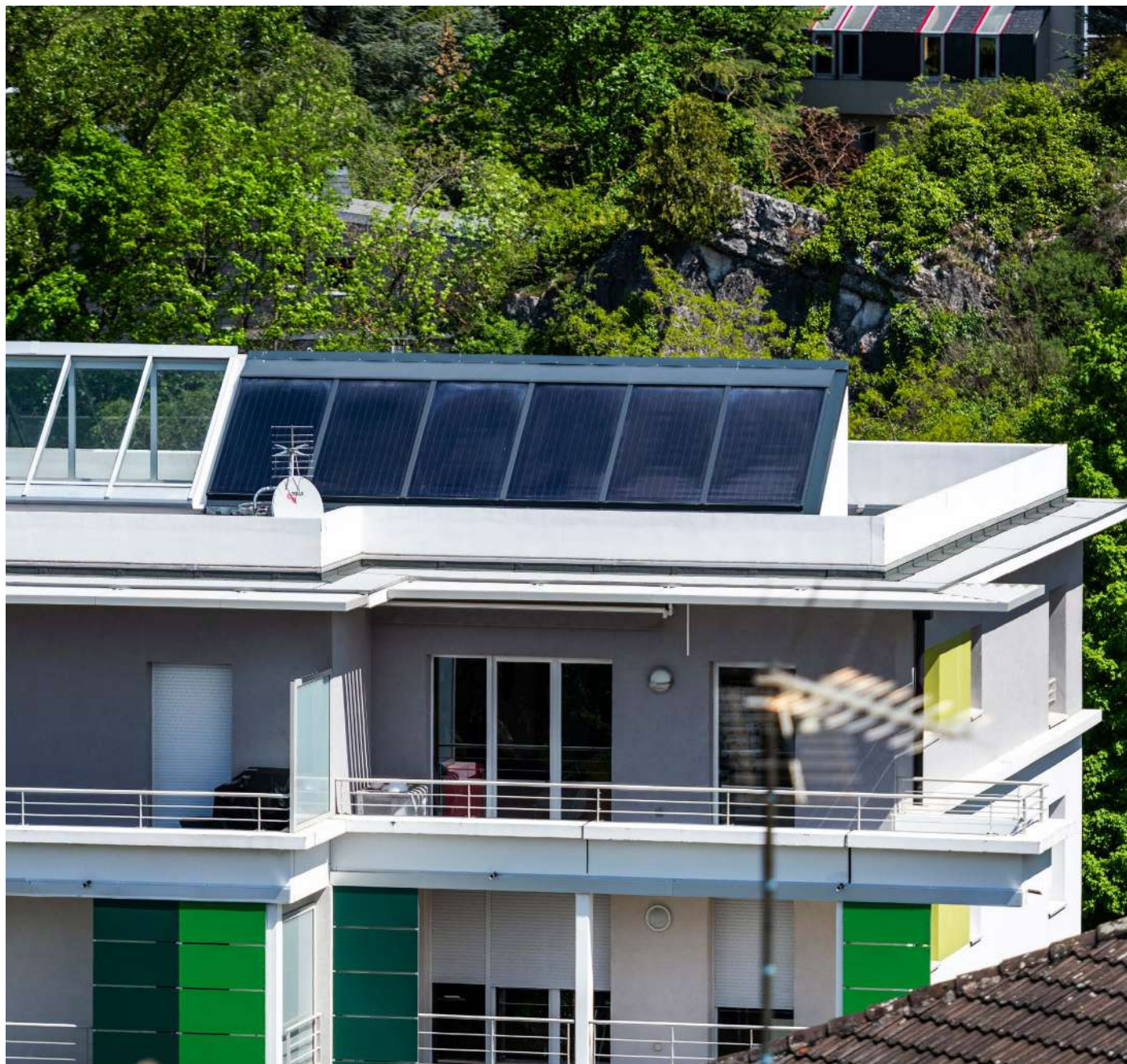
Panneaux solaires habitat Montmélian © Yannick Siegel
